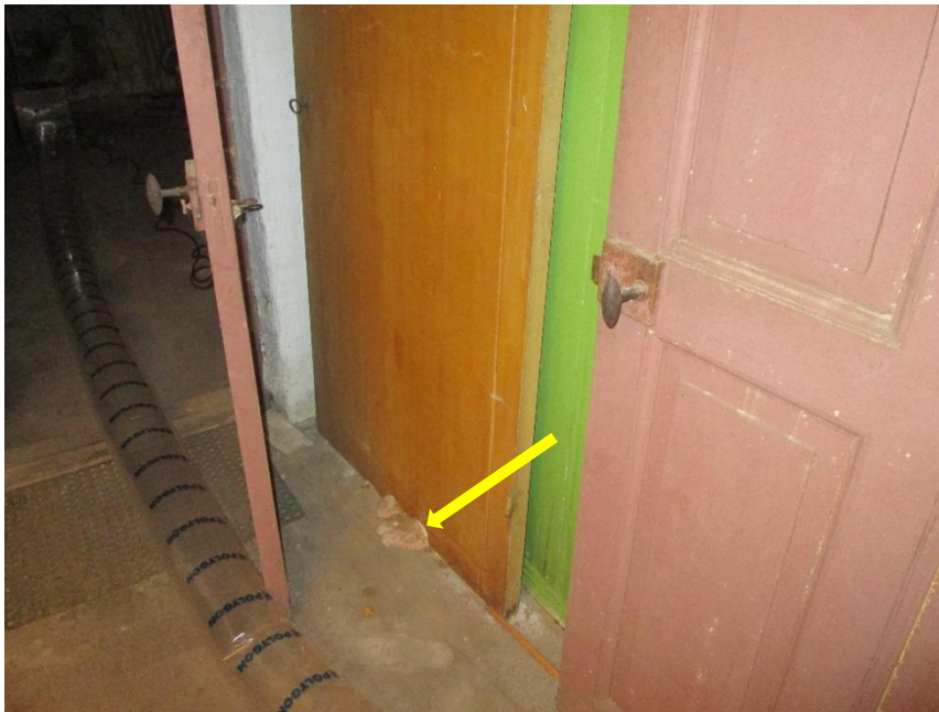
Se svamp påväxt på dörr som står mot trävägg mellan källarhall och matkällare.
