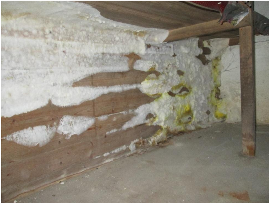
Vägg mellan matkällare och källarhall med kraftig påväxt av Äkta Hussvamp
