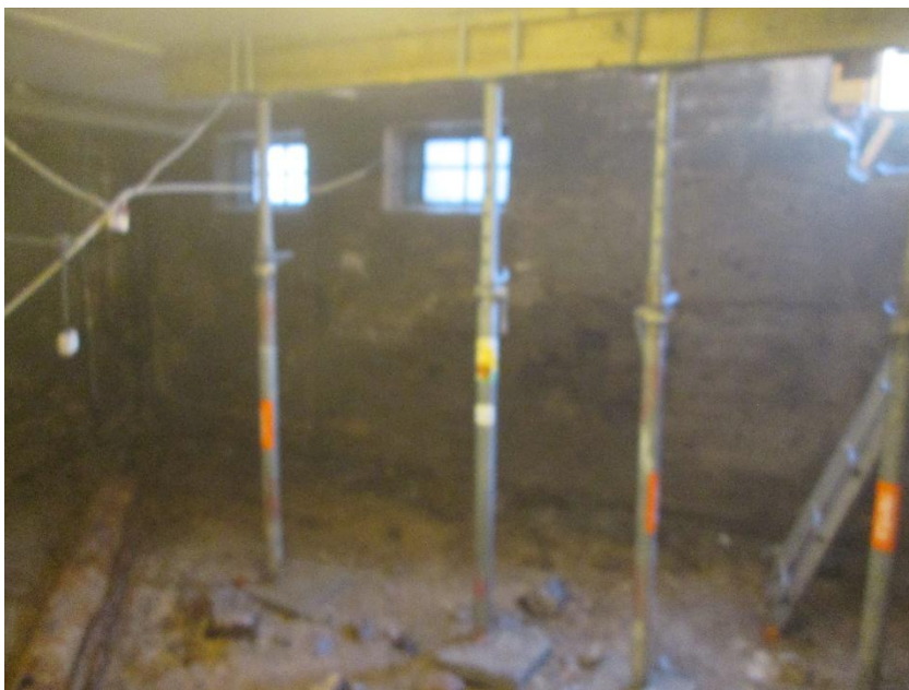
Visar utbilat golv i trapphall samt yttervägg som tagit bort puts.
