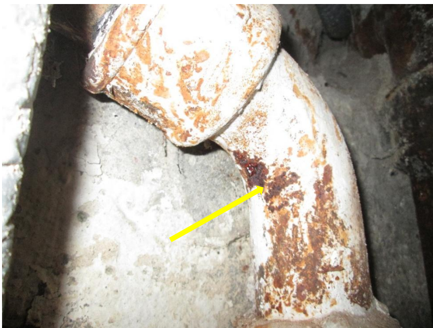
Visar avloppsrör i matkällare som läcker fram vatten.
