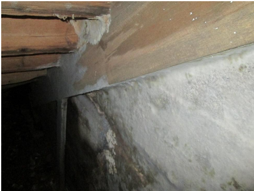
Visar yttervägg och vagns stycke till trappa med påväxt av Äkta Hussvamp.
