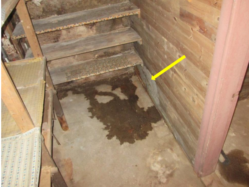
Del av matkällare se angrepp på trävägg vid gul pil.
