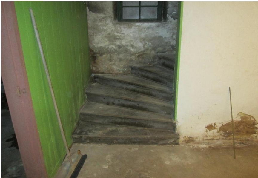
Visar trappa mellankällare och markplan med angrepp av Äkta Hussvamp.
