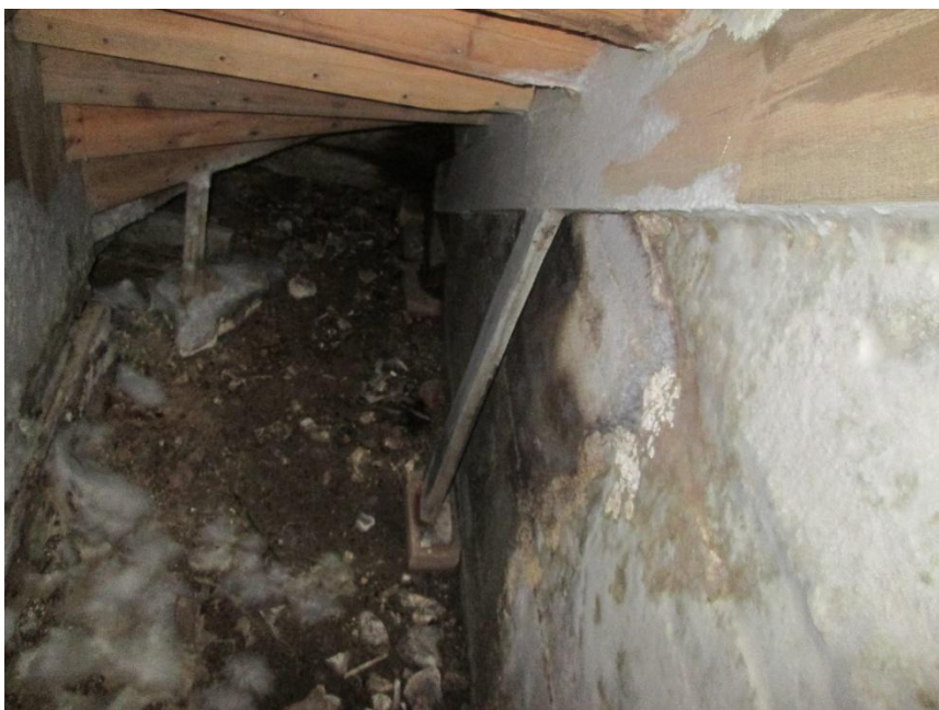
Visar utrymme under trappa med påväxt av Äkta Hussvamp.
