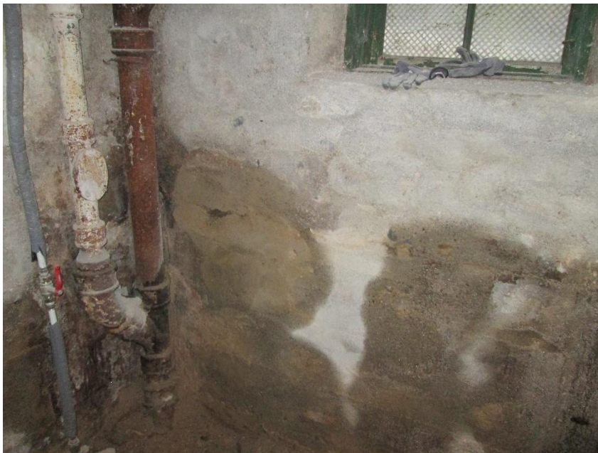
Se kraftiga fukt genomslag i yttervägg ( det rinner fritt vatten ).
