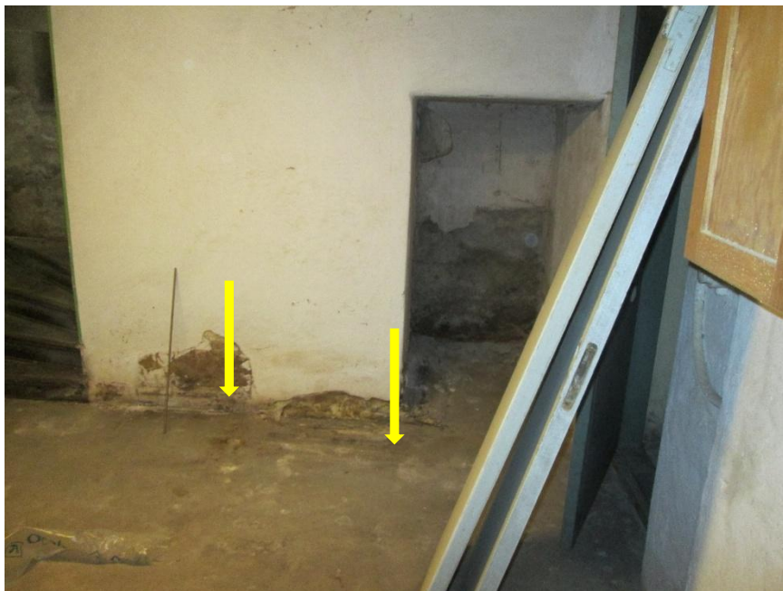
Visar del av källarhall där det sitter svampkroppar ( vid gul pil).
