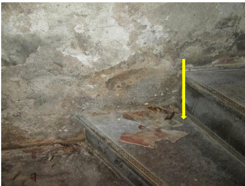
Angrepp av Äkta hussvamp på sättsteg där man ser mycel trådar vid gul pil.
